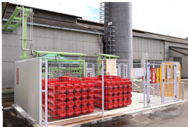
水素貯蔵設備
