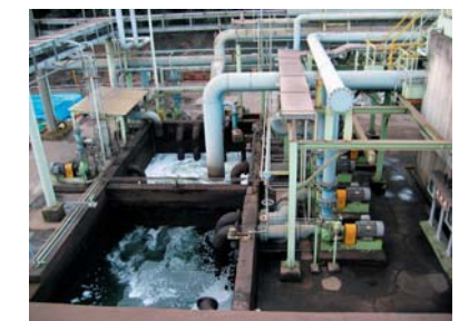
知多工場排水処理施設
